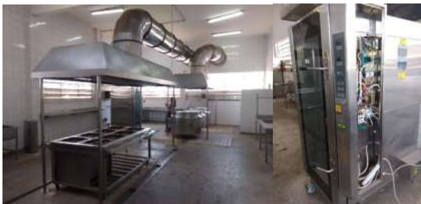
Principais equipamentos de cocção a serem recuperados/utilizados
